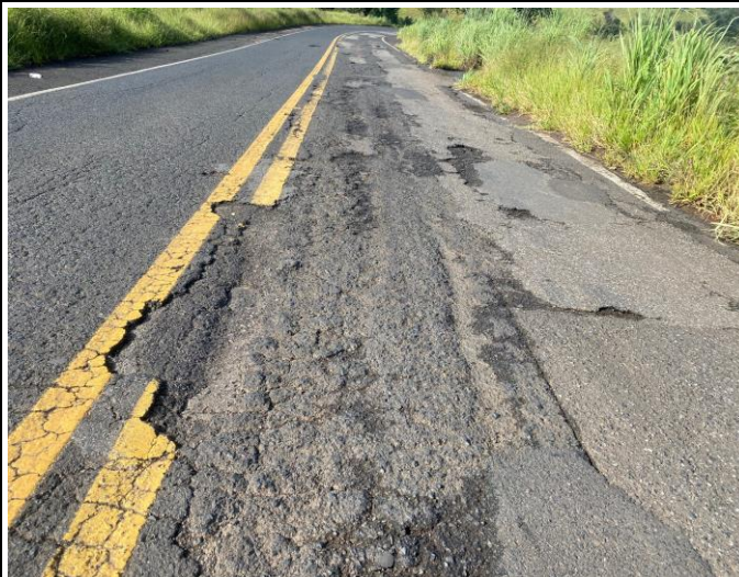
Foto 02 - Detalhe do desgaste do pavimento
